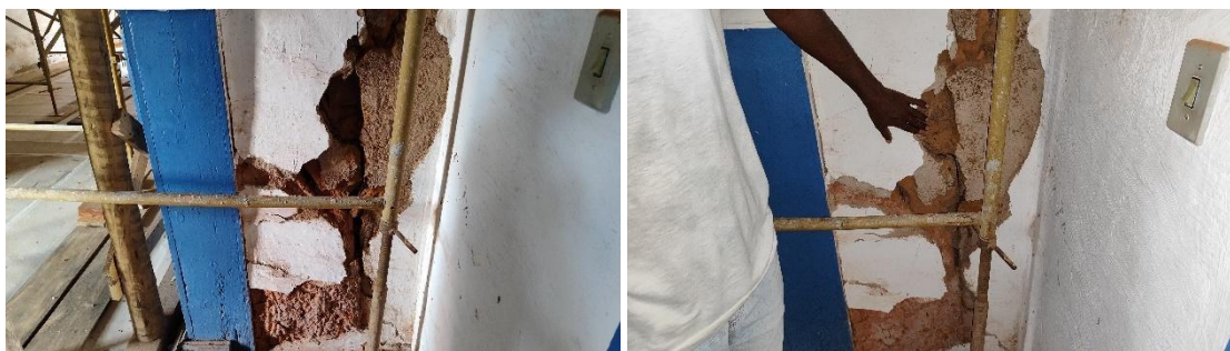
Legenda: Trincas e rachaduras na alvenaria do arco-cruzeiro. Autoria: Francielle Ferreira Data: 09/04/2024
