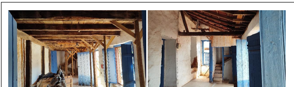
Legenda: Escoramento do piso do pavimento superior da capela lateral. Autoria: Francielle Ferreira Data: 09/04/2024
