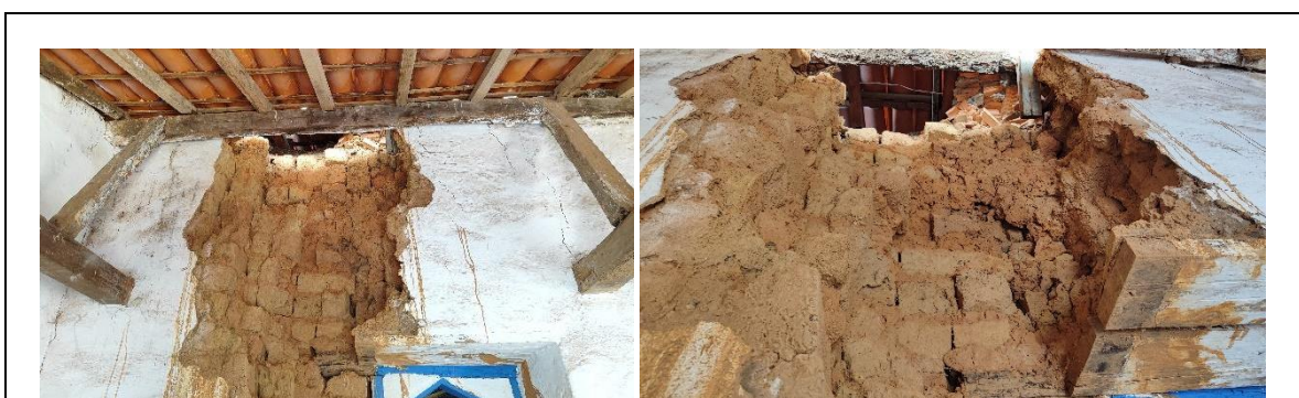
Legenda: Desagregação com perda significativa da alvenaria de adobe do pavimento superior da capela lateral. Autoria: Francielle Ferreira Data: 09/04/2024
